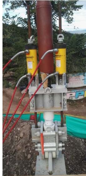
Figura 4. Equipo de tesado
