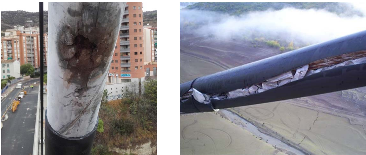
Figura 2: Corrosión en punto de inyección (izquierda) y en interior de vaina fisurada (derecha)
