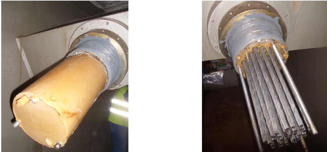
Figura 4: Vista de anclaje inferior, después de retirar el capot (izquierda) y la cera (derecha)
