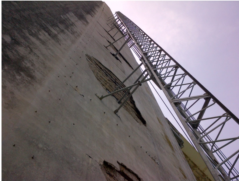
Figura 2. Daños en fuste de pila Sur.
